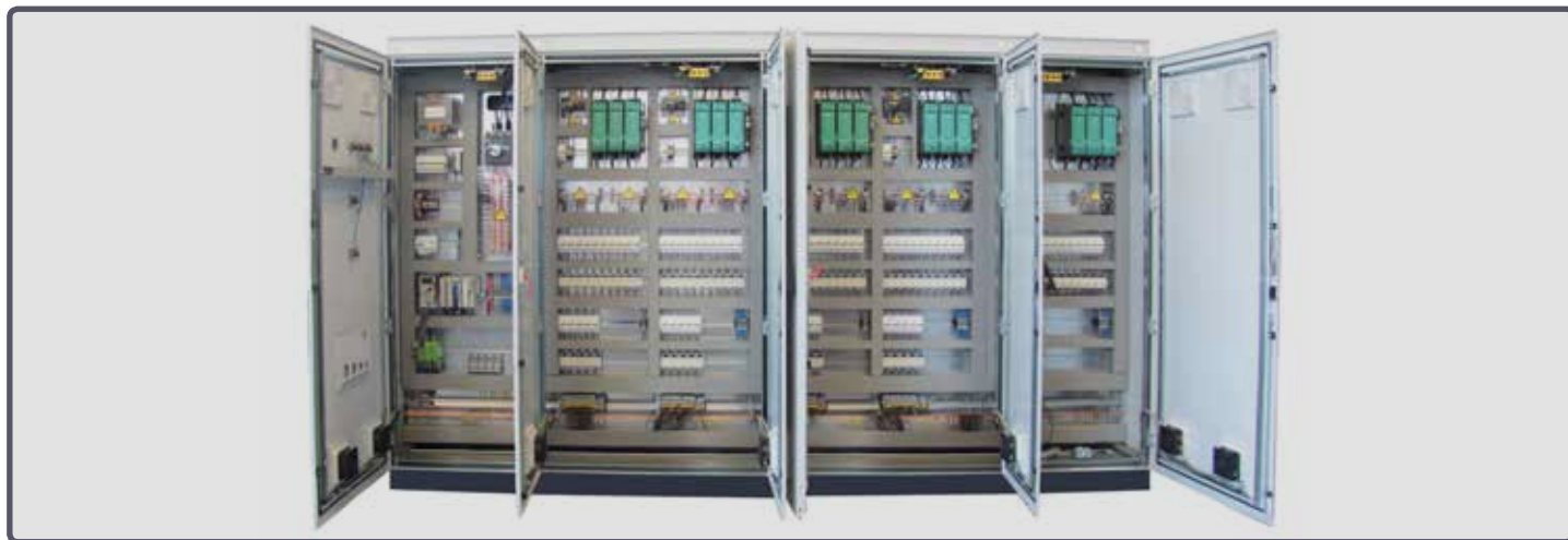
Vista armadio elettrico di comando Vista armario eléctrico de mando
